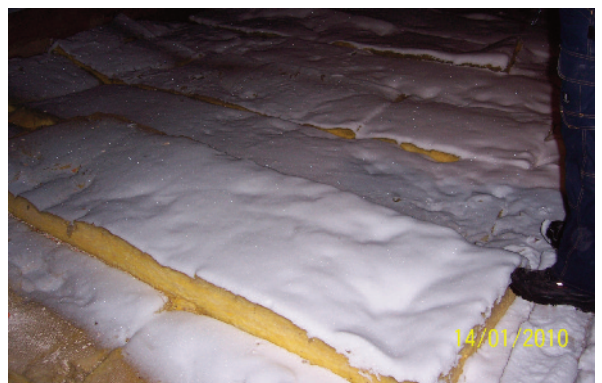
Schäden an der Dämmung durch Schneeflug auf der oberen Geschossdecke der Maria-Magdalenen-Kirche
